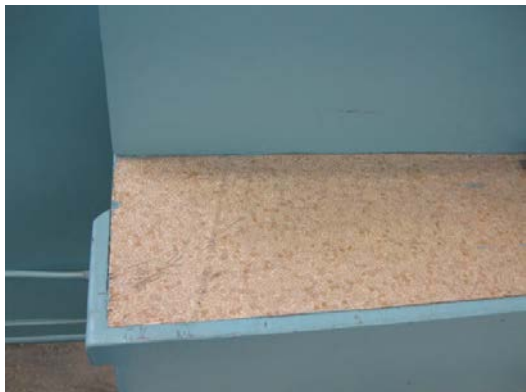
#3) Asbestos Sheet Flooring
